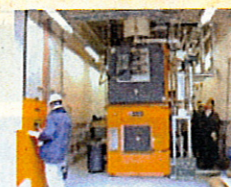
木質ペレットボイラー
